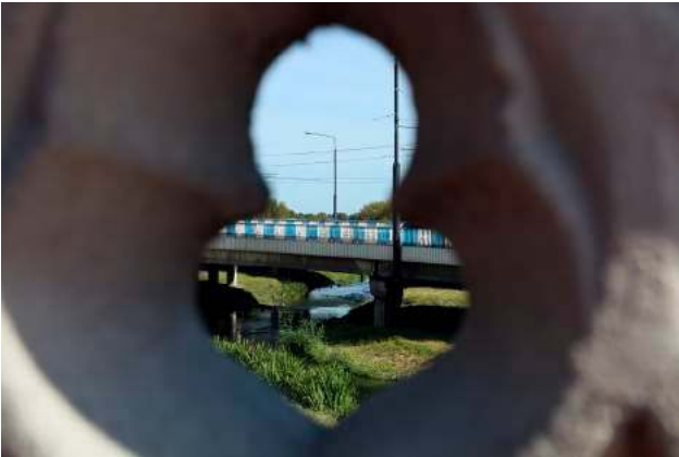
Most jest w fatalnym stanie. By mógł dalej być użytkowany wymaga dodatkowego podparcia
