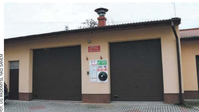
Urządzenie znajduje się na ścianie budynku remizy strażackiej w Radomyślu nad Sanem.
