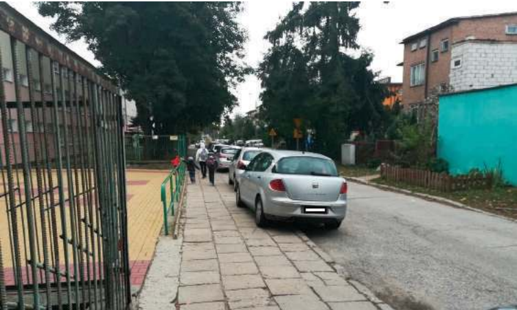
Prowadzący do podstawówki przy ul. Hiacyntowej chodnik jest połamany i popękany. Nietrudno się potknąć o wystające płytki
