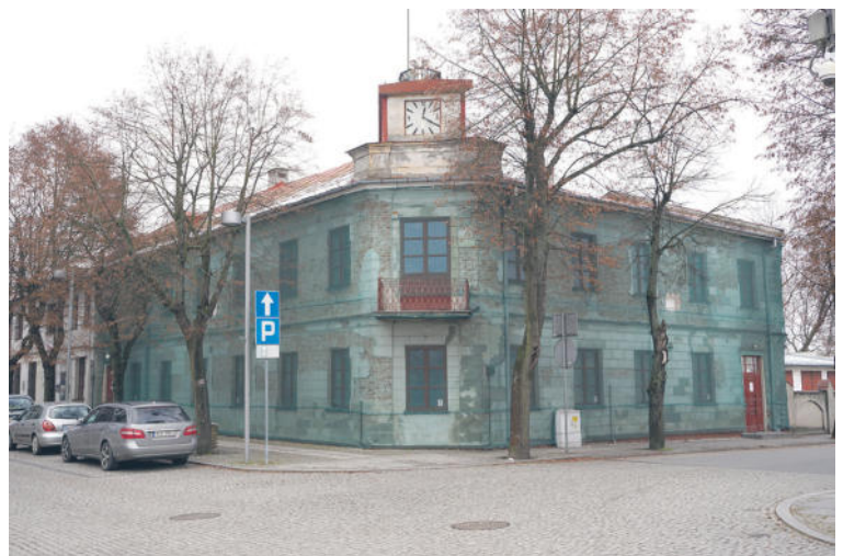
Zabytkowemu budynkowi grozi katastrofa budowlana.
