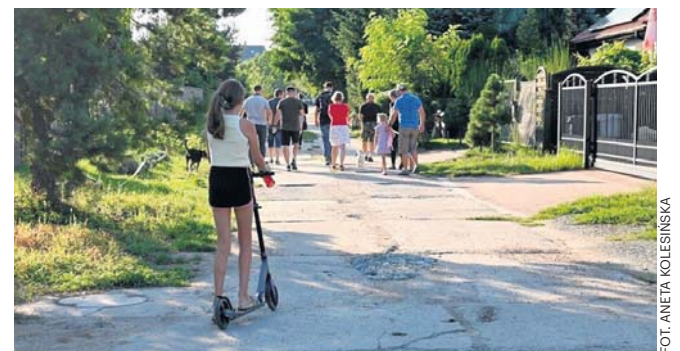
Ulica Będkowska jest w opłakanym stanie. Betonowe płyty na drodze ułożyli sami mieszkańcy, wcześniej sami za zapłacili
