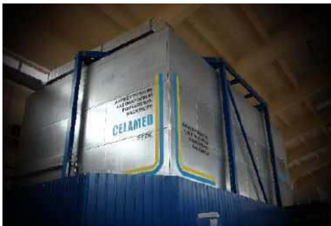
Fotografia 1. Komora SAC do badań w zakresie kompatybilności elektromagnetycznej (widok z zewnątrz)
