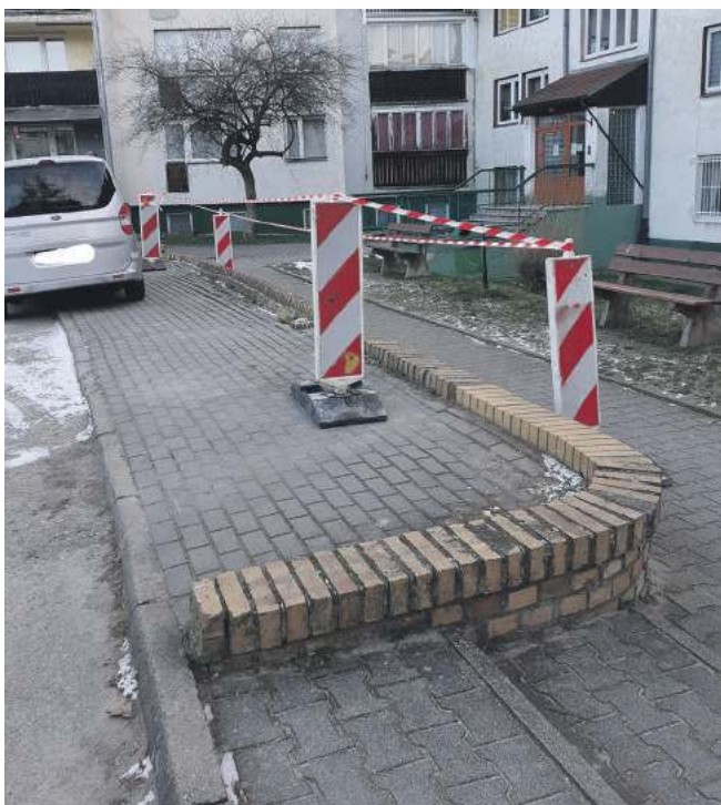
Uszkodzony murek jest już oznakowany
