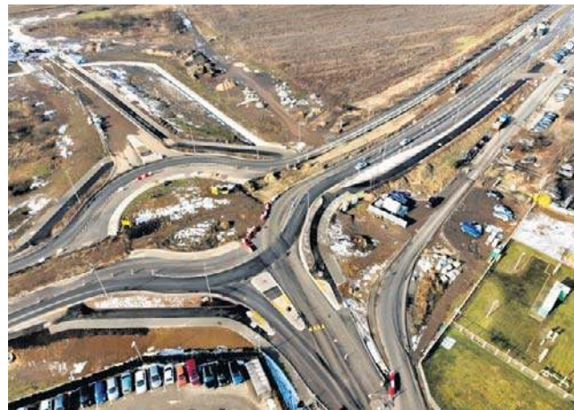
Na nowym rondzie pasy ruchu będą oddzielone od siebie tzw. „grzebieniami” z granitu.
