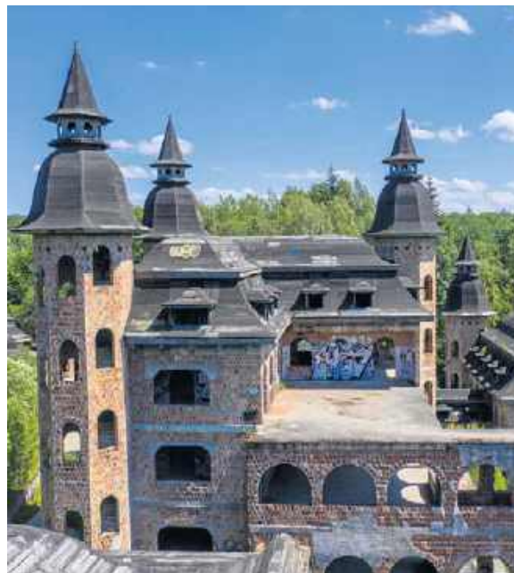
Zamek w Łapalicach - potężna ruina
