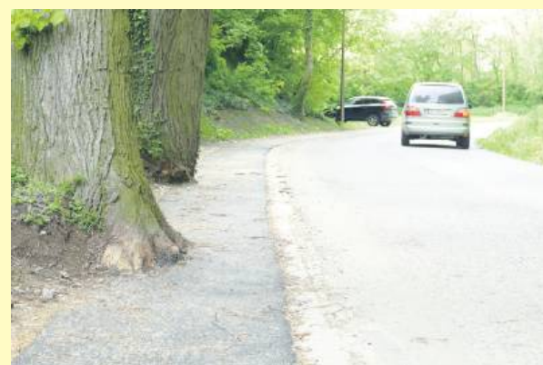
Chodnik niby jest, i to asfaltowy, ale z dzieckiem wózkami trzeba schodzić na jezdnię
