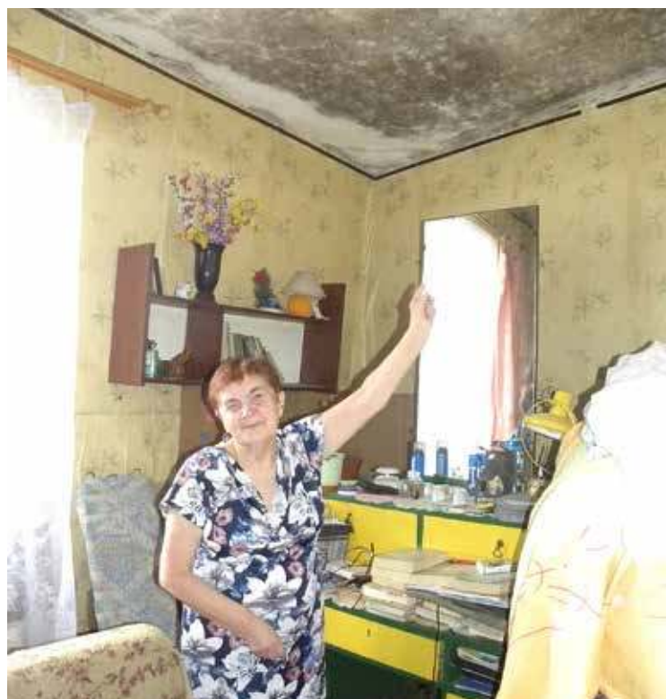
Grzyb rośnie na każdej ścianie i suficie.
