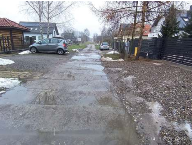
Tak aktualnie wygląda ul. Sypniewskiego. Po opadach deszczu lub w czasie roztopów dojazd do posesji staje się uciążliwy
