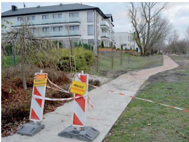
Na bulwarze brakowało 243 metrów drogi rowerowej. Dodatkowy odcinek ma mieć dwa metry szerokości i asfaltową nawierzchnię
