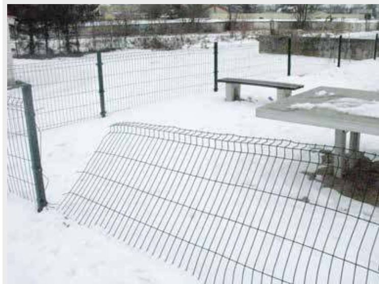
Zniszczony płot placu zabaw
