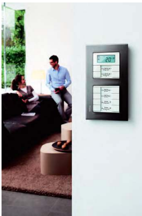
Systemowy łącznik na ścianie pokoju to tak naprawdę mała konsola sterująca wieloma funkcjami. SCHNEIDER ELECTRIC
