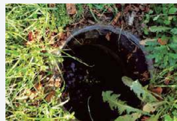
❗ Studzienka rozprowadzająca na złożo piaskowo-żwirowym.
