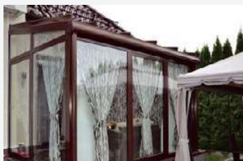
📌 Na dachu budynku zamocowano płotki przeciwnieźne do ochrony szklanego dachu oranżerii.
