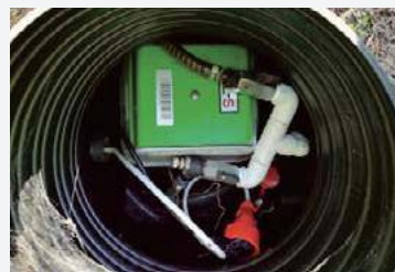
❗ Pompa napowietrzająca w nadstawce-kominie.
