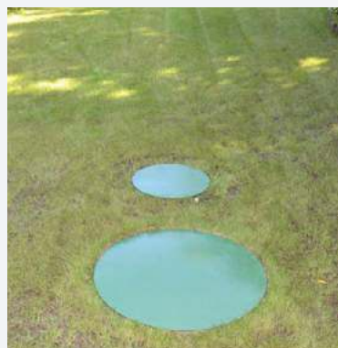
Pod dużym włazem osadnik gnilny, pod małym studzienka rozdzielcza.
