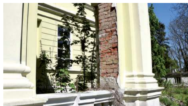
Z elewacji odpada wykonany pięć lat temu tynk
