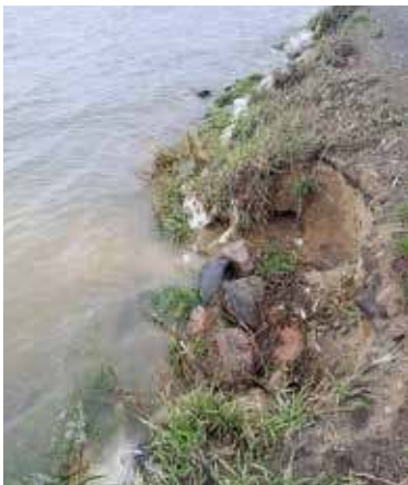
Do uszkodzenia wału doszło nieopodal Lubczyny (mł. asp. Dariusz Schacht)
