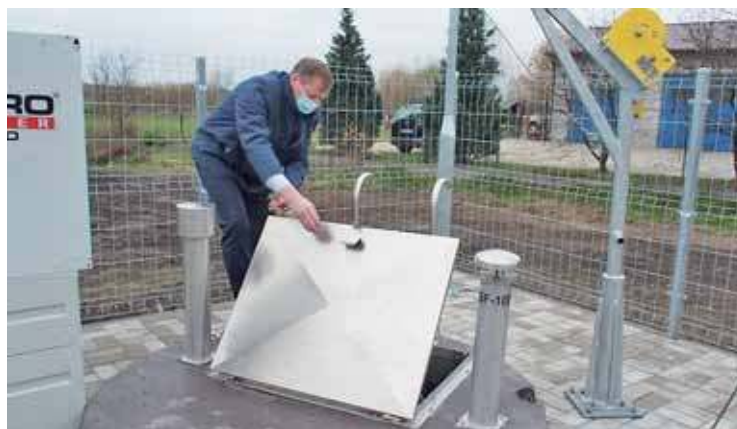
Nowa przepompownia ścieków w Rybno
