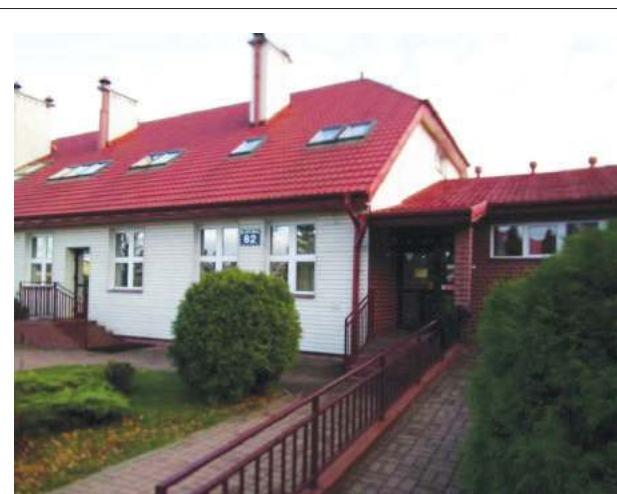
Budynek już od dawna wymaga termomodernizacji
