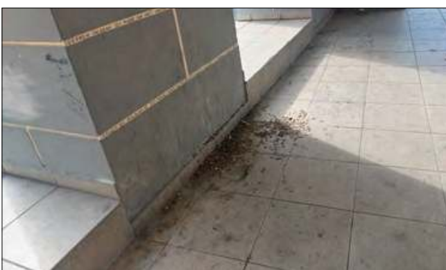
Nieestetyczny widok ptasich odchodów nieopodal krapkowickiego rynku.
