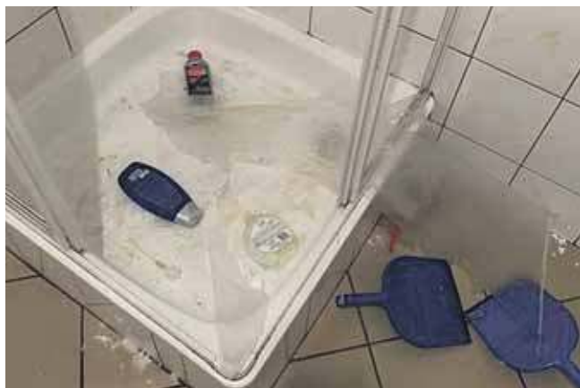
Zdewastowano m.in. prysznice
