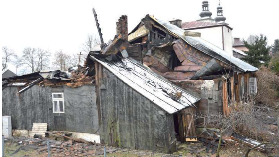
Spalił się dach, zawalił strop, wypaliło wyposażenie
