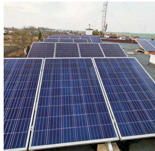
Panele fotowoltaiczne na budynku Urzędu Gminy
