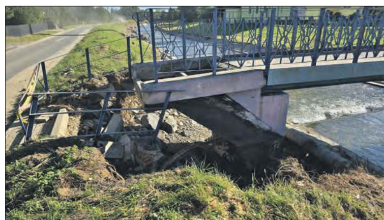
Zniszczone przęsło kładki w Łące Prudnickiej
