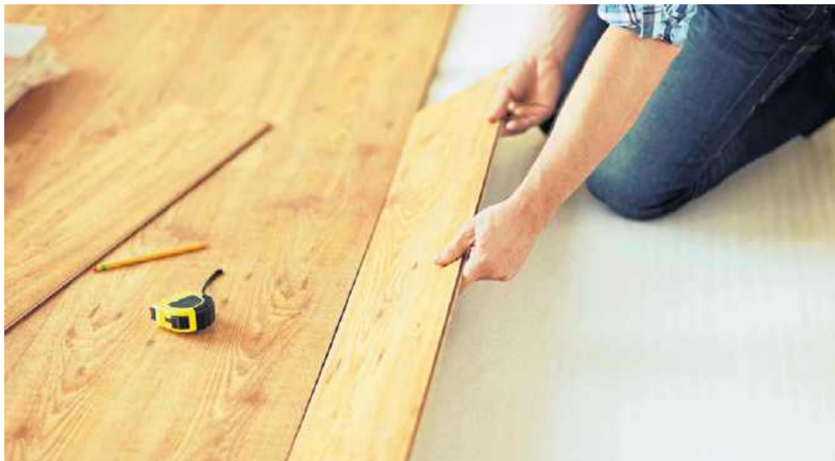
Podłogi z paneli są bardziej podatne na uszkodzenia mechaniczne, ale ich naprawa jest dość prosta.
