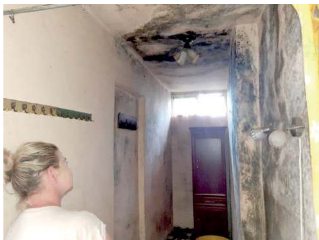
Dach na przybudówce domu przy ul. Łapiguz 74 jest nieszczelny. Lokatorzy skarżą się na wilgoć, grzyb, brak prądu w sieni
