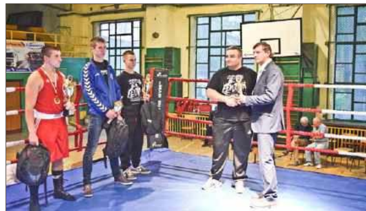
Hala, gdzie organizowane są m.in. turnieje bokserskie jest w fatalnym stanie i wymaga natychmiastowego remontu.
