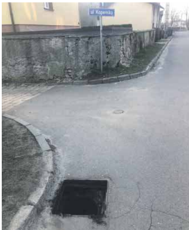
W gminie Świerklaniec zanotowano już ponad 20 kradzieży krat kanalizacyjnych studzienek
