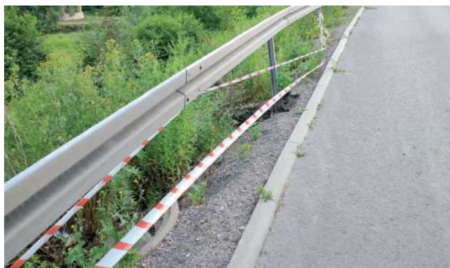
Osuwisko na ul. Pasternik
