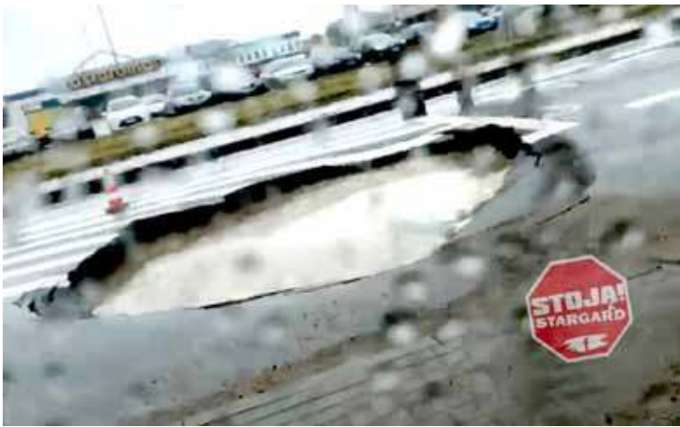
Na Kościuszki powstała ogromna wyrwa w jezdni. Foto. Stoją!Stargard
