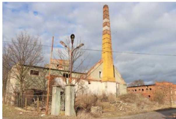
Czy budynek dawnej gorzelnii w Przewornie grozi zawaleniem?
