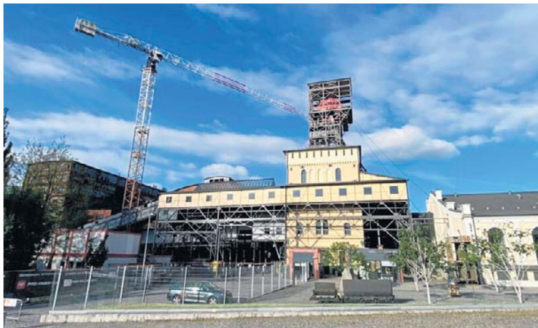
Nieprawidłowości miały miejsce podczas adaptacji starej kopalni Julia na potrzeby Parku Wielokulturowego Stara Kopalnia
