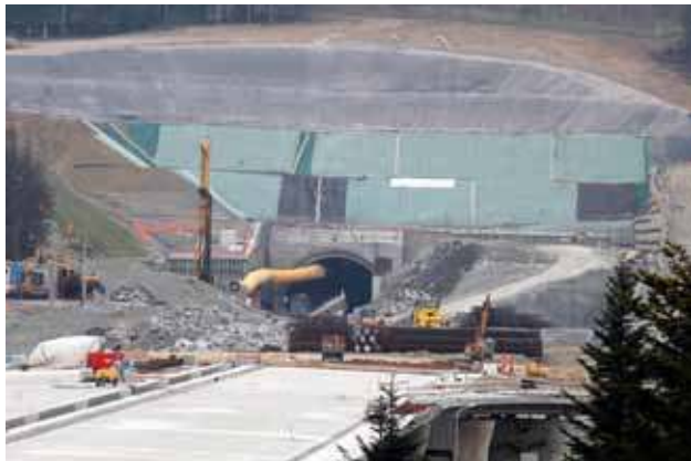
Z powodu prac przy drążeniu tunelu wyschła studnia pani Krystyny.
