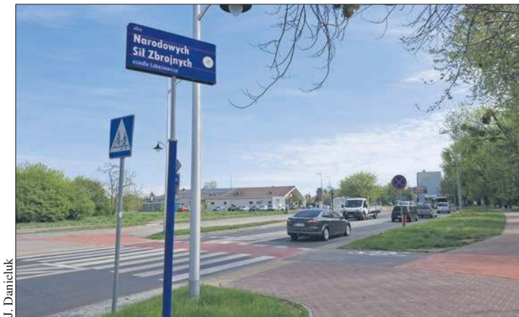
Ulica Narodowych Sił Zbrojnych wymaga remontu
