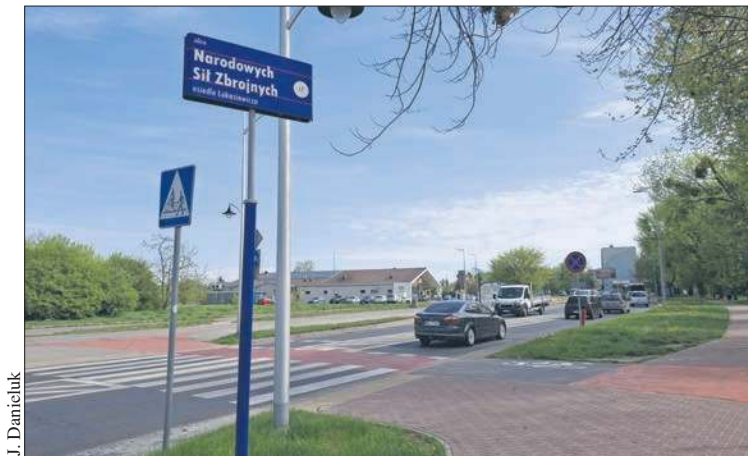
Ulica Narodowych Sił Zbrojnych wymaga remontu
