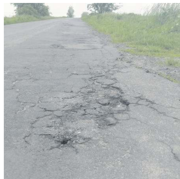
Droga z Wiązowa do Jędrzychowic ma liczne nierówności i spękania
