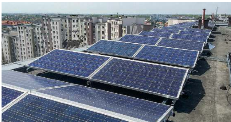
Na pracę elektrowni słonecznej wpływa jakość ogniw w panelach fotowoltaicznych | fot. mat. pras. WFOŚiGW/d
