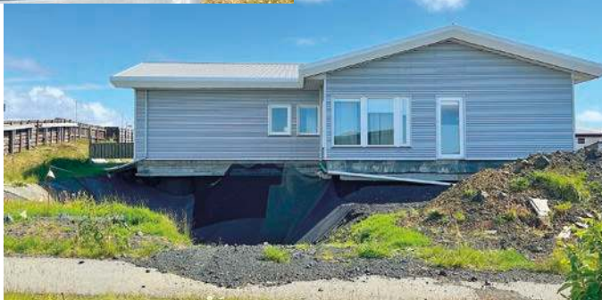
Jeden z domów uszkodzonych wskutek pęknięć ziemi i aktywności wulkanicznej. Pod budynkiem powstała głęboka wyrwa.
