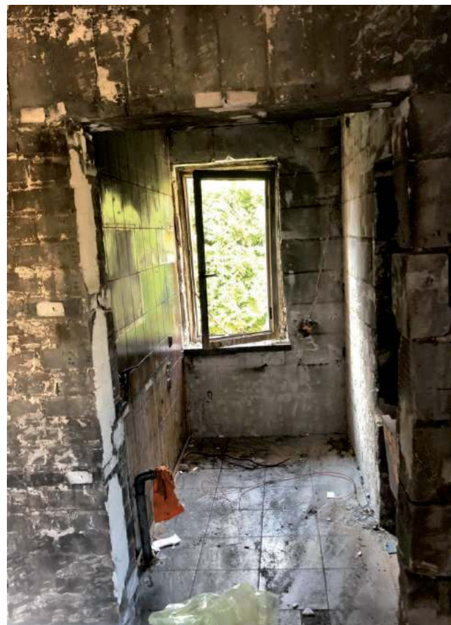
W pomieszczeniach zostały puste ściany. Pogorzelcy muszą wyremontować całe piętro
