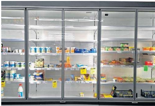
Uszkodzeniu uległy dwa regały lodówki
