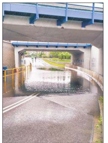
Przejazd pod wiaduktem na ul. Świątosława znów został zalany.
