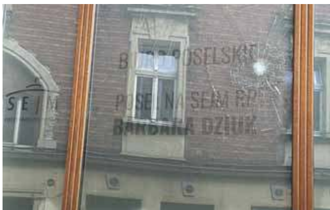
Uszkodzona szyba w biurze posłanki Barbary Dziuk
