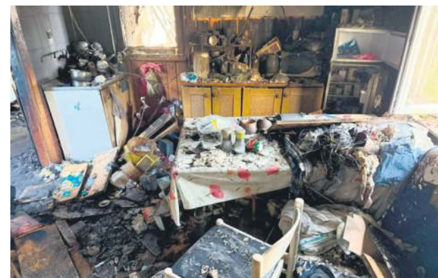
Budynek nie nadaje się do zamieszkania.
