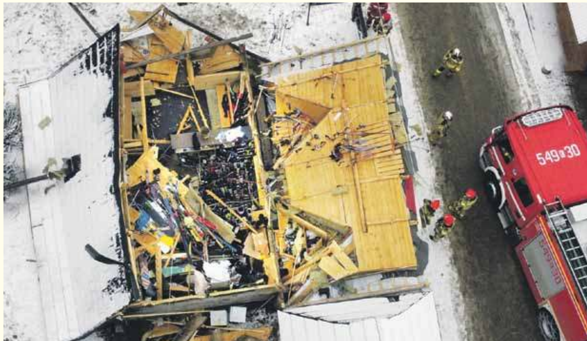
Budynek został niemal całkowicie zniszczony.
