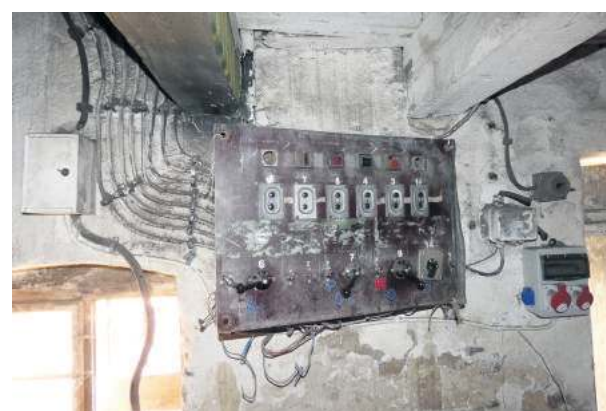
Tak wygląda stara tablica rozdzielcza, do której doprowadzona jest aluminiowa instalacja elektryczna
