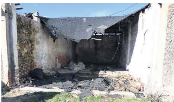
Dużym obciążeniem finansowym dla nowego właściciela będzie pozbycie się papy, której gruba warstwa znajduje się na dachu
