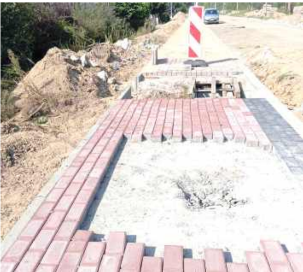
Do niedawna w tym miejscu na środku nowo budowanego chodnika stał słup energetyczny. Został usunięty na początku września po interwencji mieszkańców i radnego
