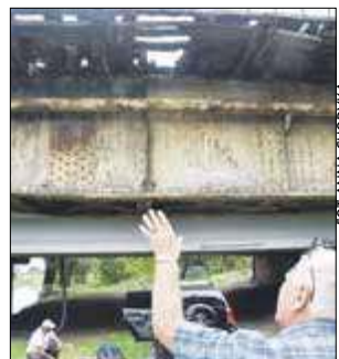
– Elementy mostu mogą się oberwać i spaść na ścieżkę rowerową, komuś na głowę. Mogą nawet kogoś zabić czy zranić – zauważa białanin
