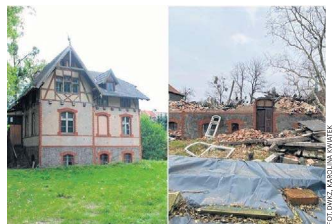
Po 120-letniej, zabytkowej willi pozostały fundamenty i piwnica. Nielegalną rozbiórkę bada prokuratura
