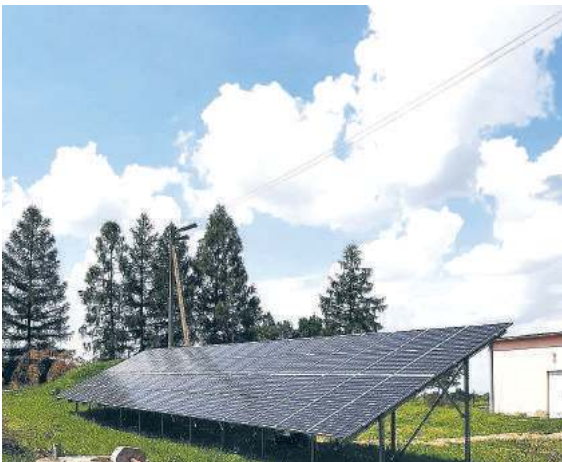
Instalacja fotowoltaiczna w Surhowie
