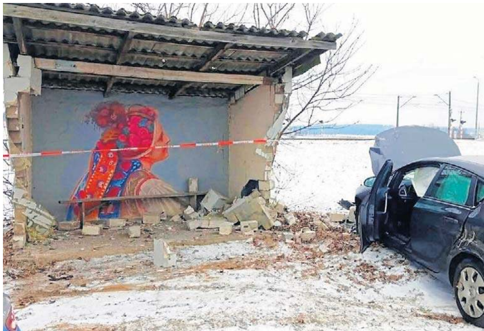
17 lutego 20-letni mieszkaniec pow. poddębickiego, kierując oplem astrą, na zaśnieżonej nawierzchni stracił panowanie nad pojazdem i uderzył w wiatę z malowidłem Panny Młodej. Władze gminy nakazały natychmiastową rozbiórkę obiektu
