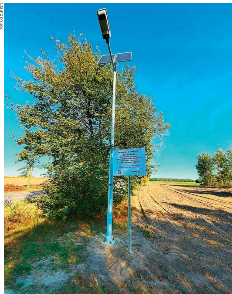
Lampy solarne na terenie gminy Ojrzeń
